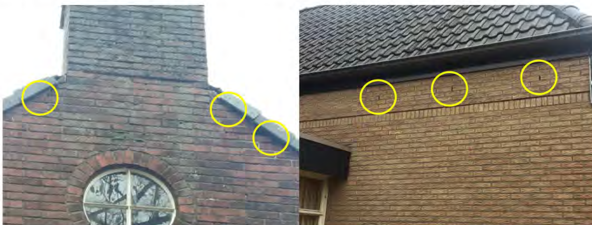
Foto links; zichtbare openingen in de buitengevel en ruimtes tussen de gevelpannen en buitengevels vormen potentiële verblijfplaatsen/invliegopeningen in de woning. Foto rechts; zichtbare openstootvoegen vormen potentiële invliegopeningen in het zaalgebouw.
